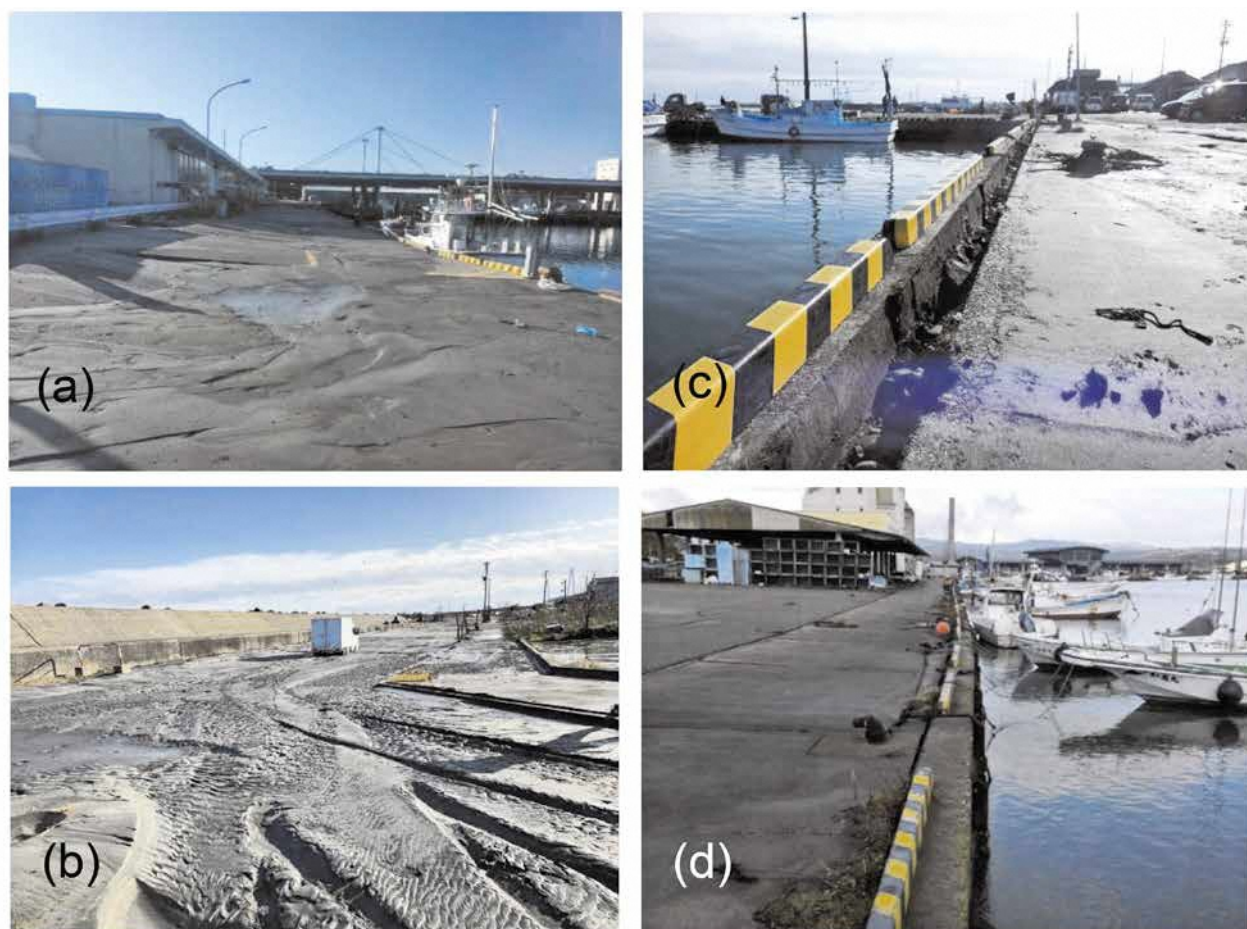
図1 能登半島地震による富山県での漁港の被害状況。(a) 岸壁エプロンの沈下(新湊漁港東地区)、(b) 液状化による臨港道路の噴砂(新湊漁港東地区)、(c) 物揚場の傾倒・沈下(新湊漁港西地区)、(d) 物揚場の傾倒・沈下(氷見漁港)。
