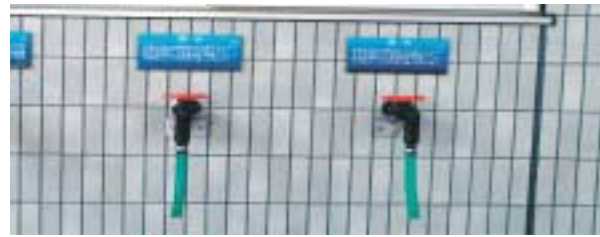
海洋深層水取水施設
