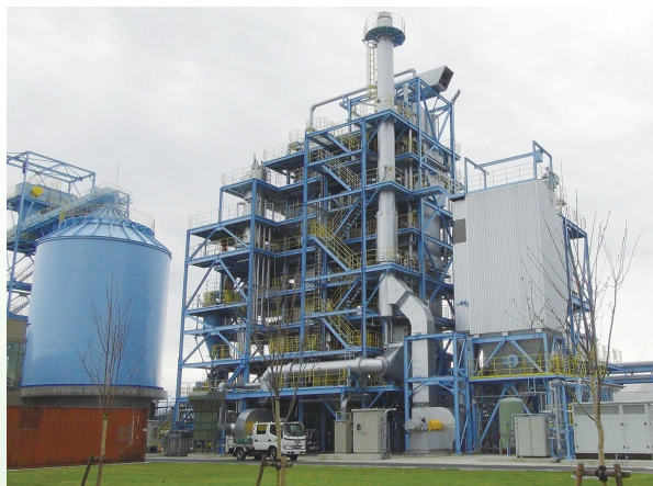
稼働を開始した木質バイオマス発電所
