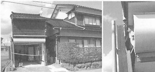
図-13 柱頭が破壊した車庫（穴水）
