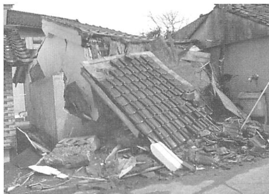
図-10 土蔵の転倒（穴水）
