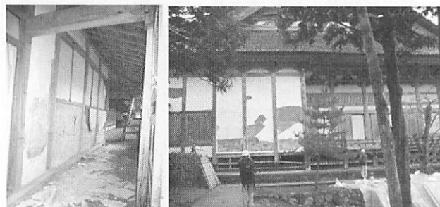
図-5 総持寺祖院の漆喰の剥落（門前）
