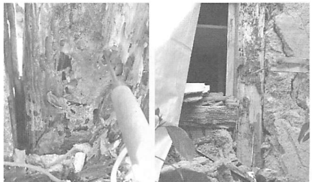
図-21 躯体柱脚や土壁内部にみられた腐朽・蟻害痕
