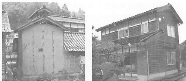
図-2 土蔵の亀裂と漆喰の剥落（氷見市姿）
