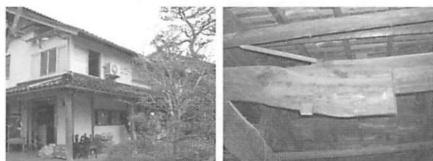
図-8 2階小屋組の地棟梁の継手の緩み（穴水）
