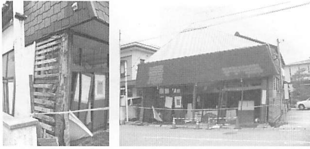
図-22 店舗の開口脇に多く見られた劣化被害
