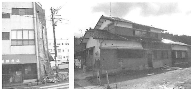
図-32 外壁の落下(穴水)
