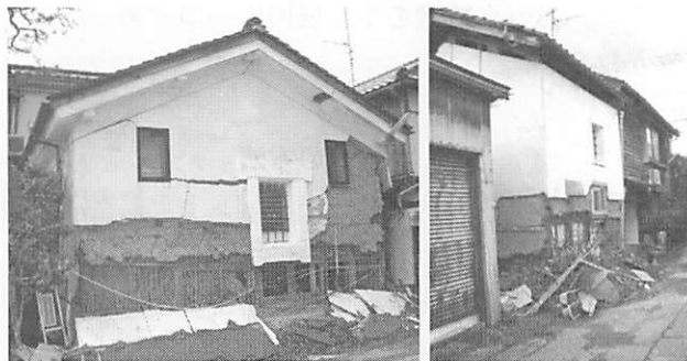
図-3 下部の塗り土の脱落（穴水）
