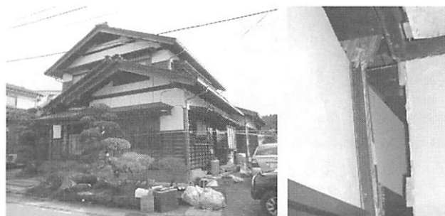
図-6 内部で柱に折損のある住宅（穴水）
