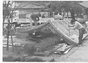
ア) 倒壊した手水舎
