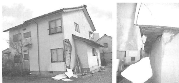
図-9 水平移動した住宅（穴水）
