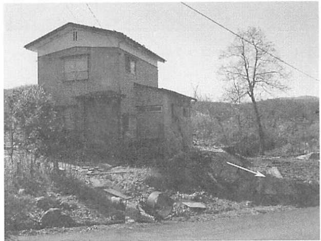
図32 コンクリート擁壁の転倒（和南津地区）
