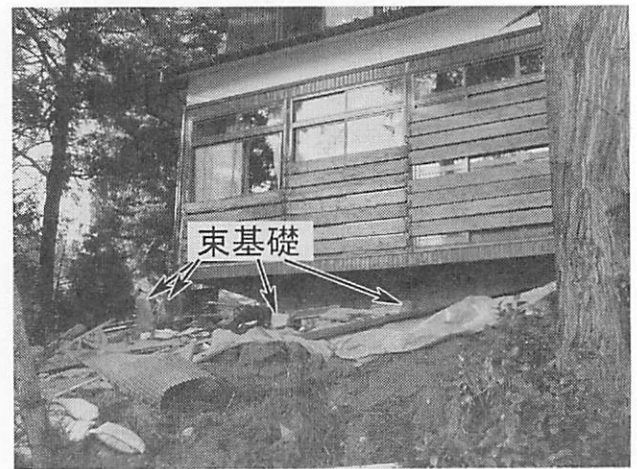
(b) 基礎の被害状況
