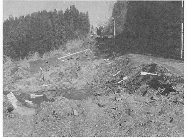
図28 盛土崩壊による舗装道路の被害(和南津地区)
