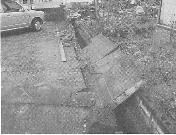
図34 転倒したブロック塀（川口町川口地区）
