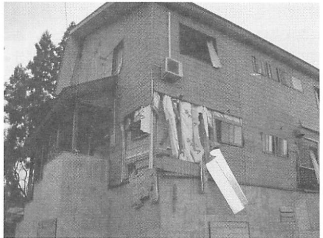
図7 浴室ユニットの衝突による外壁の破壊（田麦山地区）
