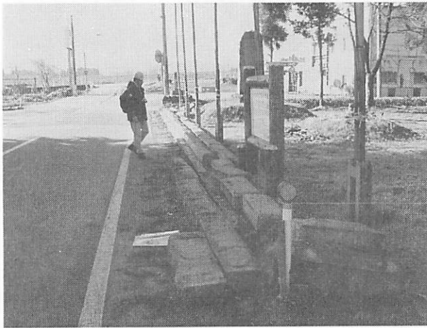
図35 神社の石積みの塀の転倒（川口地区）
