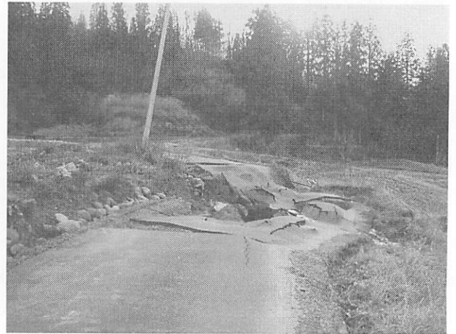
図37 斜面崩壊によるアスファルト道の陥没 （田麦山地区田中付近）
