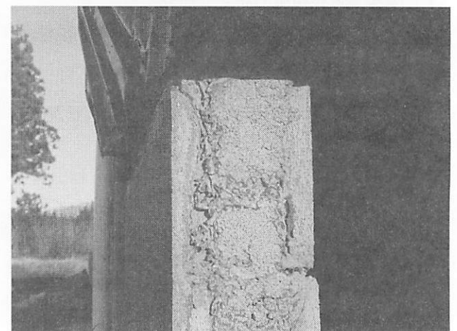
図25 コンクリートブロック基礎にみられた蟻道（田麦山地区）
