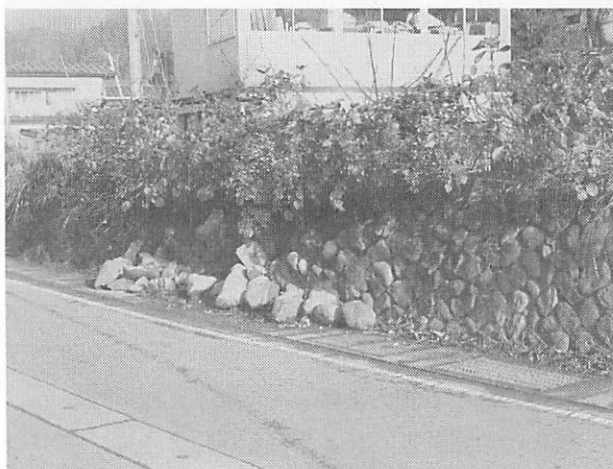
図36 石垣の崩れ（川口地区）
