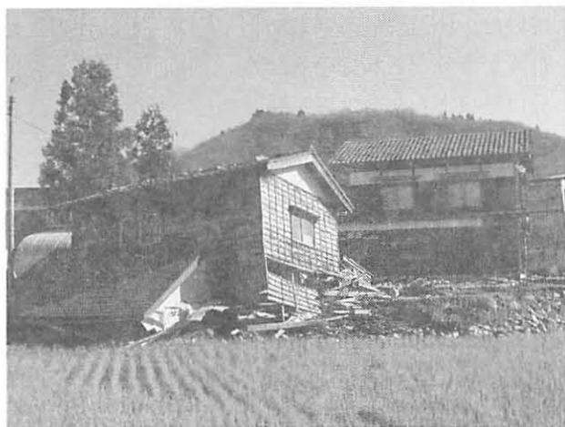
(a) 1階が崩壊した住宅の外観
