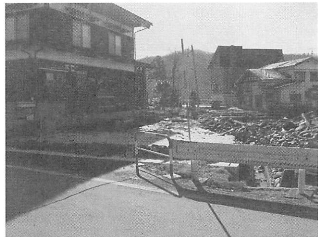
図33 被害の小さい家屋の宅地（和南津地区）
