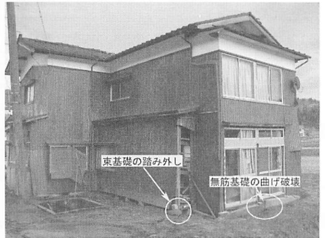
図3 無筋基礎の破壊と東基礎の踏み外し
