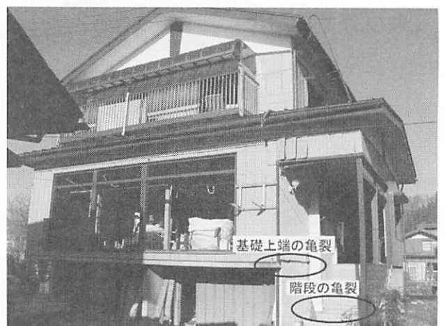
図4 上部構造のズレと外部階段の亀裂(川口地区)
