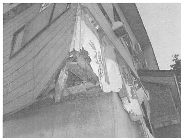
(b) 柱脚部分の破壊状況
