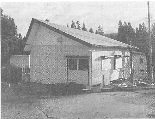
図15 1階車庫が崩壊した木造家屋 (田麦山地区田中付近)
