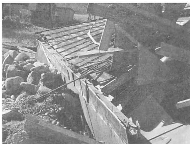
(b) 土台-柱脚接合部の破壊状況
