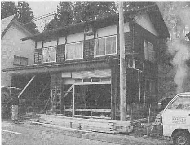
(a) 建物の外観。仮筋交いで補強と耐力壁の追加が行なわれている。
