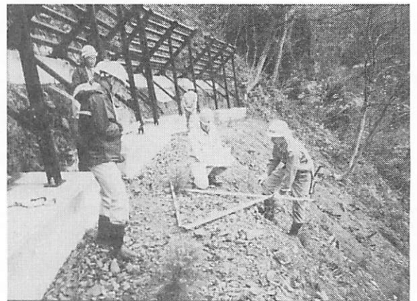
写真-1 鋼製雪崩予防柵の施工例(旧上平村)
