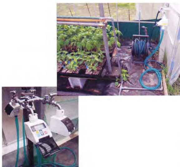
写真-3 自動灌水設備
