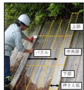
図 2 腐朽度の測定
