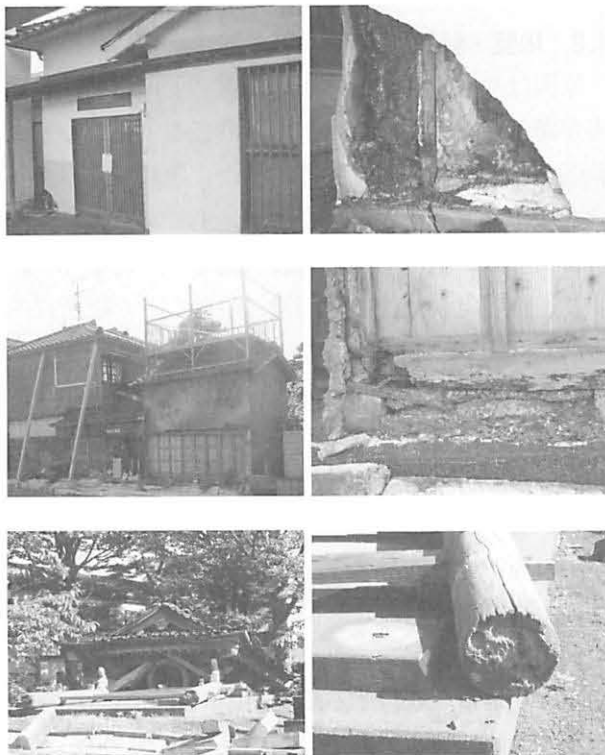
図16 隅角部柱脚の腐朽・蟻害痕（柏崎市）
