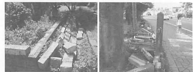
図33 無筋石造の塀柵の転倒(柏崎市)
