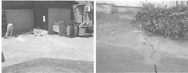
図23 宅地に現われた亀裂や噴砂痕（柏崎市）
