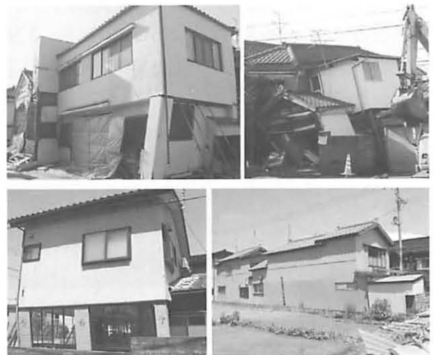
図10 開口過多や壁量不足の専用住宅の被害(柏崎市)
