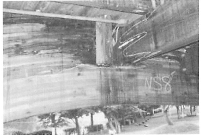
写真8 欄干と梁取り付け部の桁材腐朽
