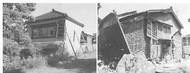
図4 土塗壁家屋の大きな残留変形（柏崎市）
