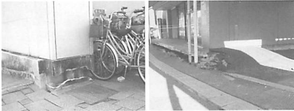
図25 商業ビルの基礎・地盤被害（柏崎市）
