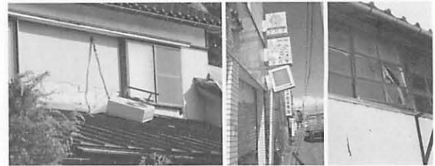
図31 落下の危険がある非構造物材(西山町、柏崎市、刈羽村)
