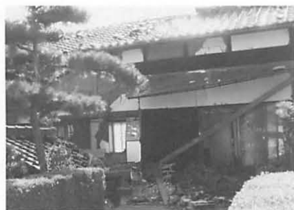
図2 漆喰の剥落（刈羽村）
