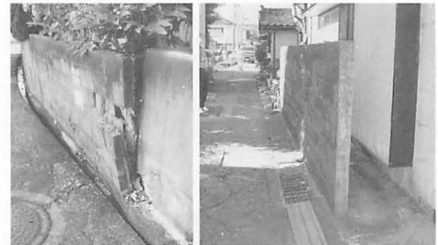
ア) 配筋で転倒を免れたブロック塀
