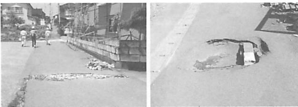
図24 住宅地の道路の亀裂、陥没（柏崎市）
