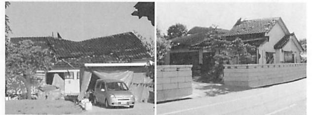
図14 小屋組みの崩壊（刈羽村）
