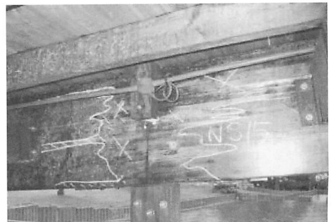
写真10 欄干を付けた桁継ぎ手部の腐朽
