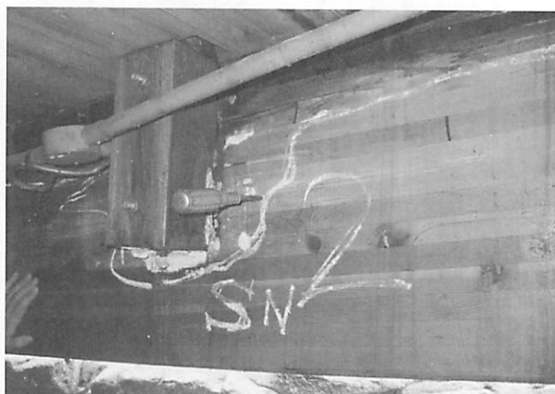
写真6 桁材の欄干取り付け部の腐朽
