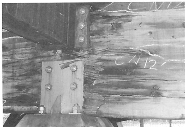
写真9 桁継ぎ手の腐朽(部分的に破壊)
