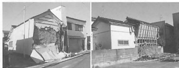
図3 振動や塀への衝突による塗土の脱落（柏崎市）
