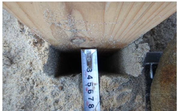
写真4 防風柵支柱の地際部分での空隙
