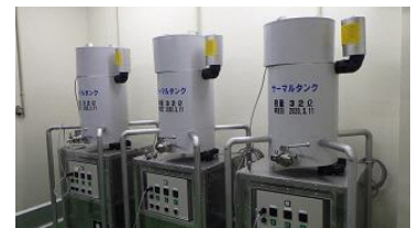
温調仕込みタンク
