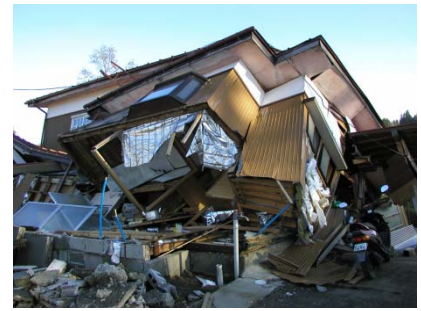
木造住宅の被害
